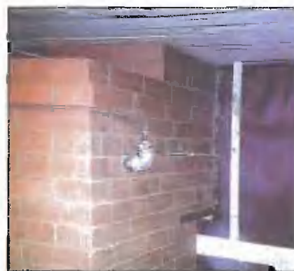
Боров, ведущий к наружной трубе
